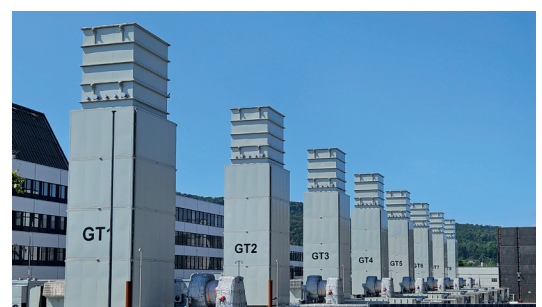
Centrale de réserve au gaz de Birr/AG
